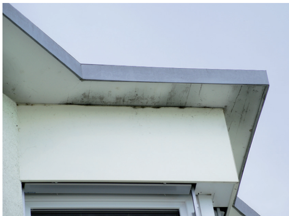
Fig. 5: Image de dégât
